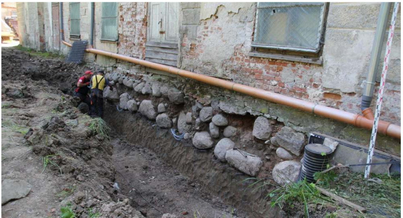
Bild 1 Vorgefundener Zustand des Fundamentmauerwerks auf der Nordseite zum Park, vor der Ertüchtigung
