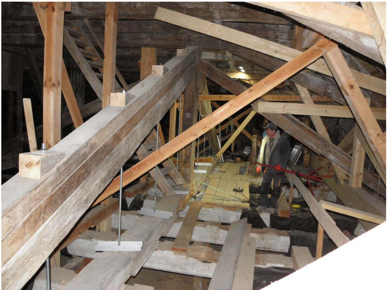
Bild 4 Beginn der Sanierung des Hängewerkes im Dachgeschoss zur Abfangung der Deckenbalken über dem Treppenraum
