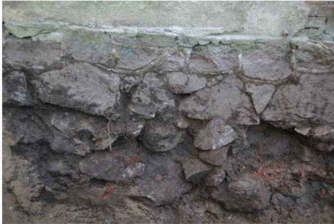
Bild 1 Marodes Fundament am Kernbau, z.T. ausgebrochen
